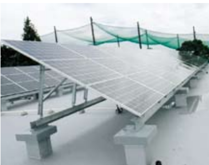
▲加茂名小学校の太陽光発電システム
