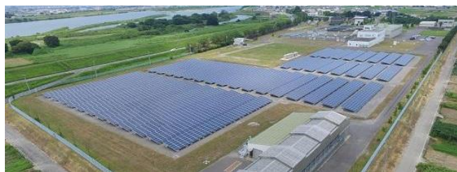
太陽光発電設備（第十浄水場）
